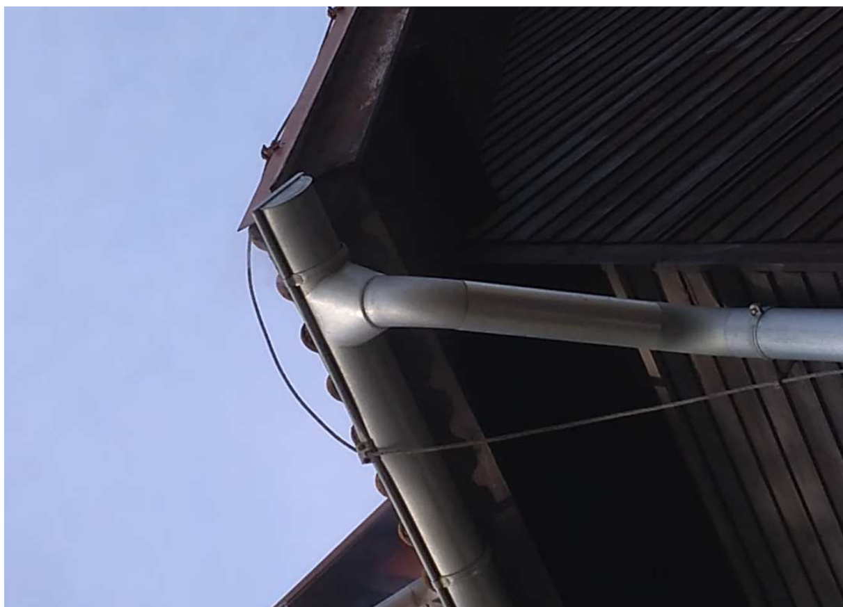
Závada 1: Napojení jednoho dešťového svodu u č. p. 11, východní část objektu. Ve Žďáře nad Sázavou 15. 5. 2020
